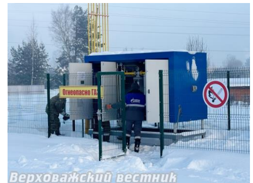
Газовая котельная в с. Чушевицы
